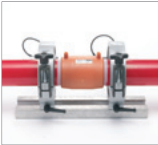
Рис. 99 Подготовить второй конец трубы, полностью вставить в электросварную муфту и закрепить в устройство для фиксации трубы
