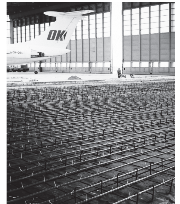
Напольное отопление для промышленных зданий
