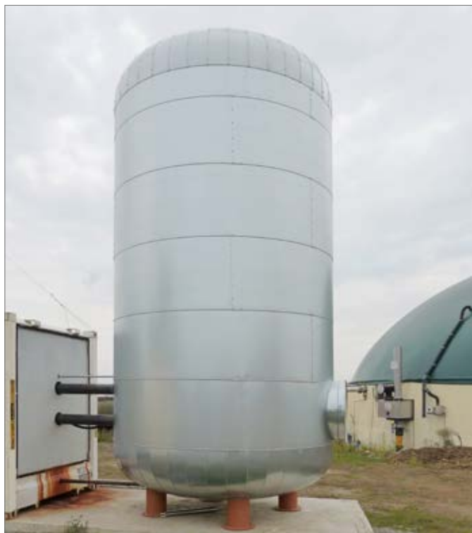
Рис. 6-8 Центральный аккумулятор тепла
