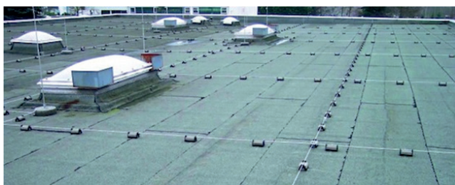
Молниеприемная сетка на плоской кровле
