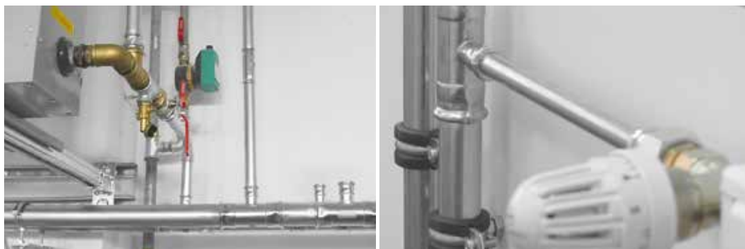
Примеры монтажа оборудования KAN-therm Steel
