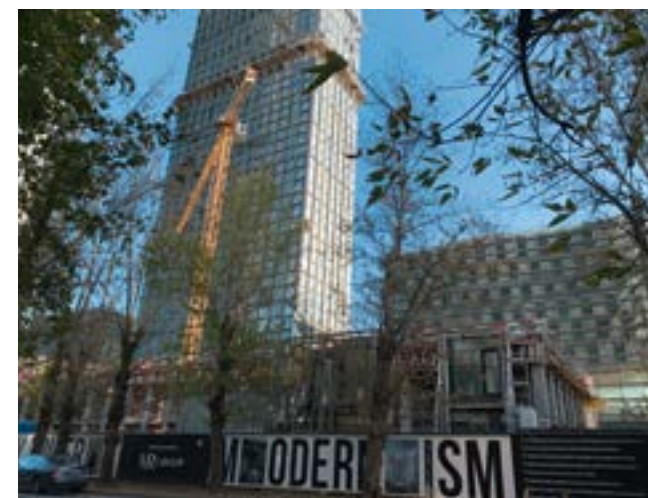
ЖК «Mod». Введена в эксплуатацию малошумная внутренняя система канализации из НПВХ.
