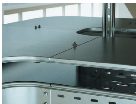
Двойной непрерывный контур заземления по лотку и по крышке
